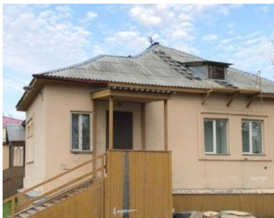
ГБУЗ АО «Первая городская больница им. Волосевич», филиал – детская поликлиника в пос. Цигломень Адрес: г. Архангельск, ул. Красина, д. 3 Результаты (состояние объекта): нет пандуса, деревянное крыльцо
